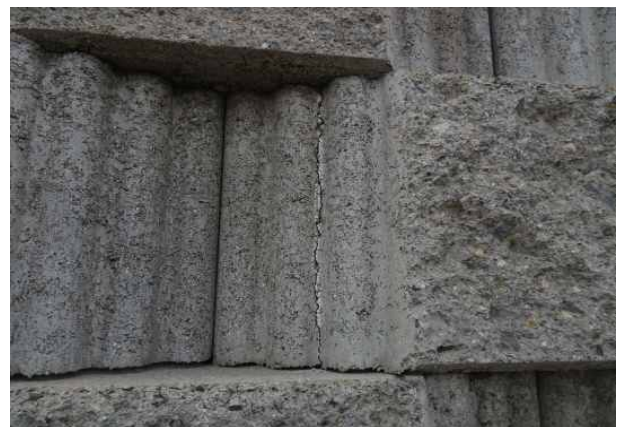
전면부 균열 0.2mm/0.2m 4구간
