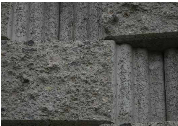
전면부 균열 0.1mm/0.2m 1구간
